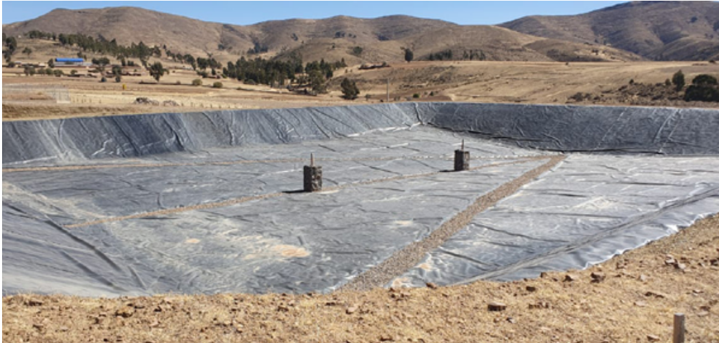
Figura 23. Sistema de almacenamiento de lixiviados
